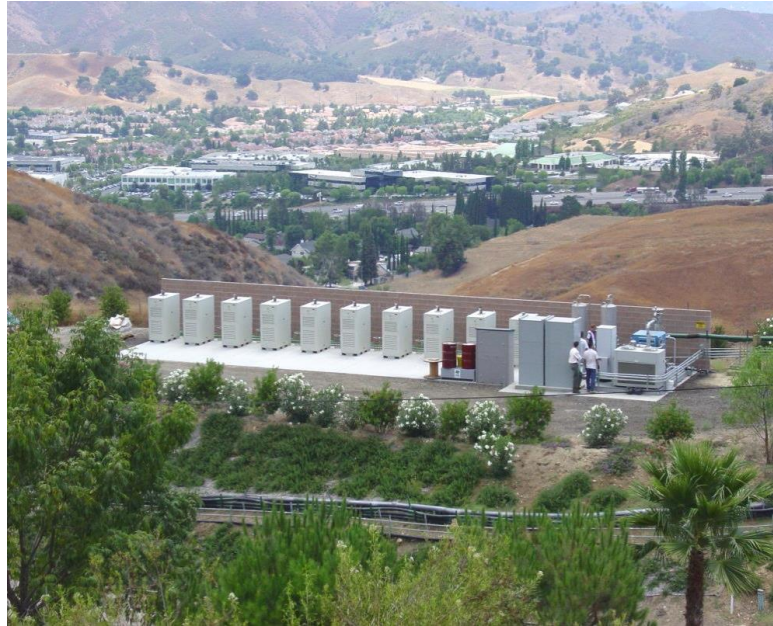
Calabasas Landfill Micro Turbines
