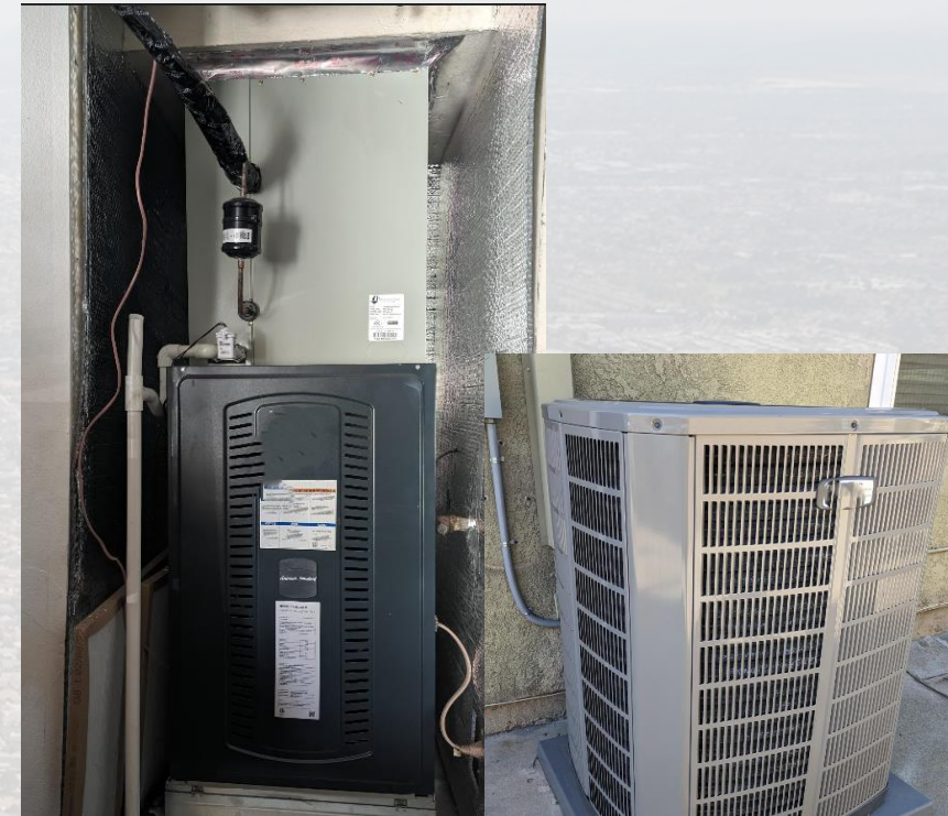
Heat Pump for Space Heating and Cooling (Split System With Indoor and Outdoor Units) Bomba de calor para calefacción y refrigeración de espacios (Sistema Split con Unidades Interiores y Exteriores)
